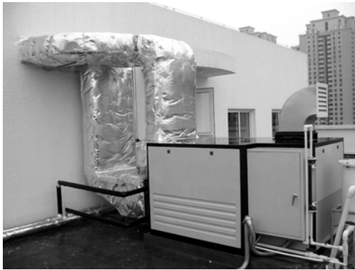
图 9 通过喷水对排风热回收的溶液除湿新风机组
